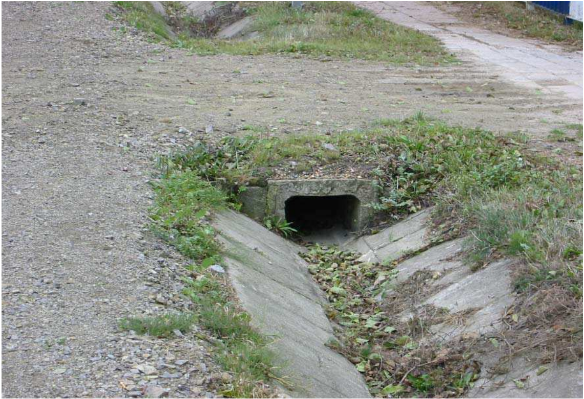
Fot. 9. Odwodnienie w stanie zadowalającym. Przepust w pełni drożny (bez zanieczyszczeń), rów z prefabrykatów betonowych nieznacznie zamulony, z porastającą roślinnością.
