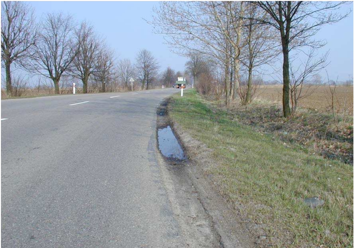
Fot. 56. Pobocze skoleinowane oraz odwodnienie w niezadowalającym stanie technicznym.
