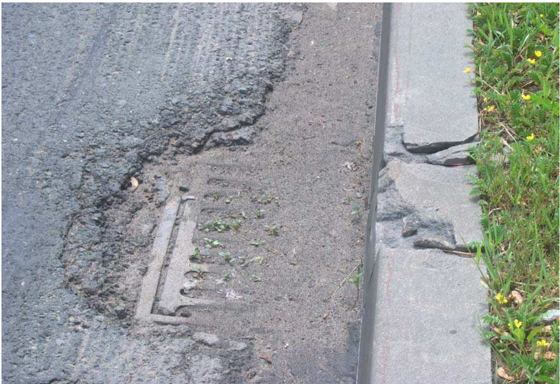
Fot. 37. Całkowicie zasypana studzienka (łącznie z kratką). Brak możliwości odprowadzania wody.
