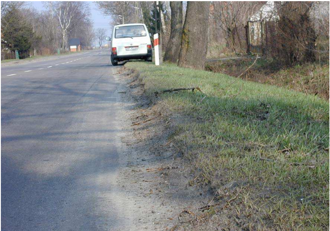
Fot. 53. Zawyżenie pobocza powodujące obsypywanie się ziemi na nawierzchnię.
