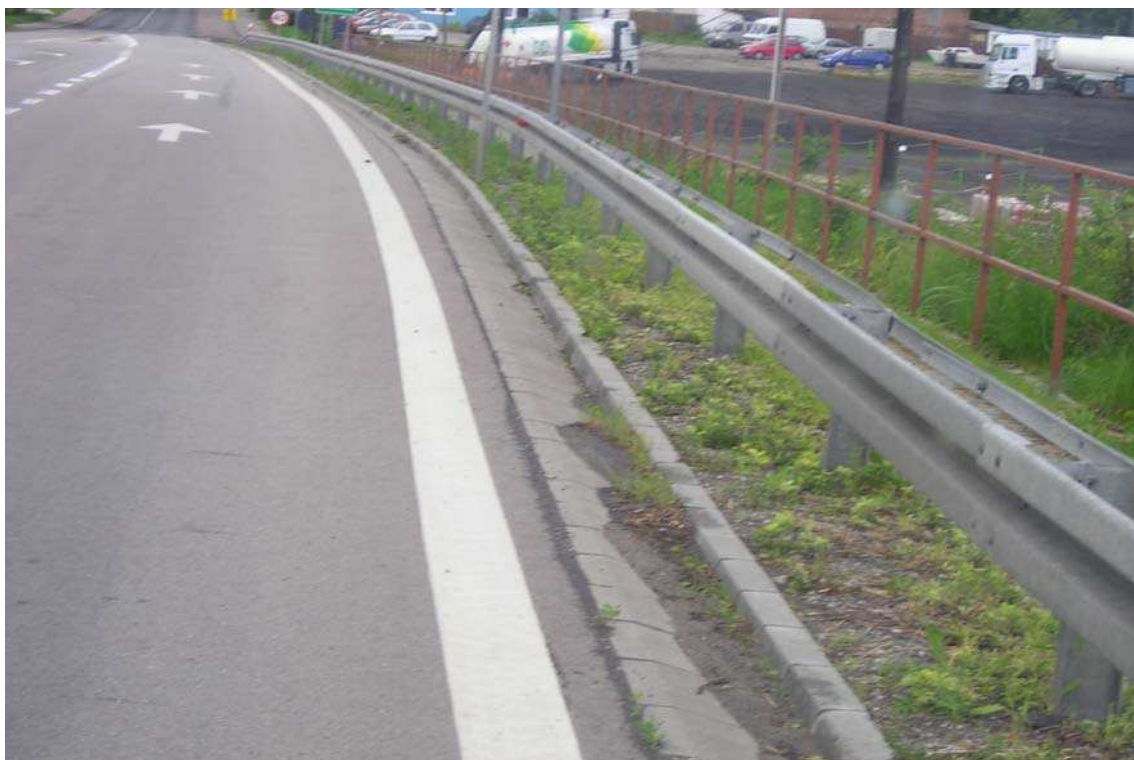
Fot. 16. Rynna przykrawężnikowa miejscami zasypana piachem.
