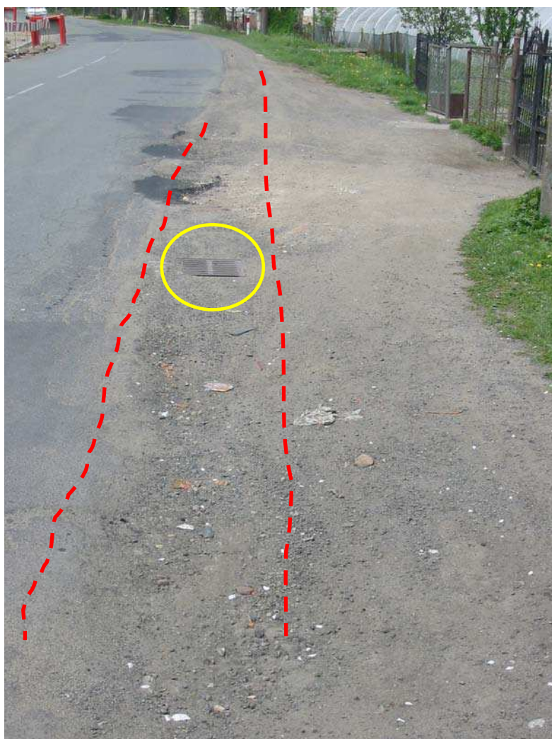
Fot. 31. Brak elementów doprowadzających wody opadowe do wpustu studzienki kanalizacyjnej.
