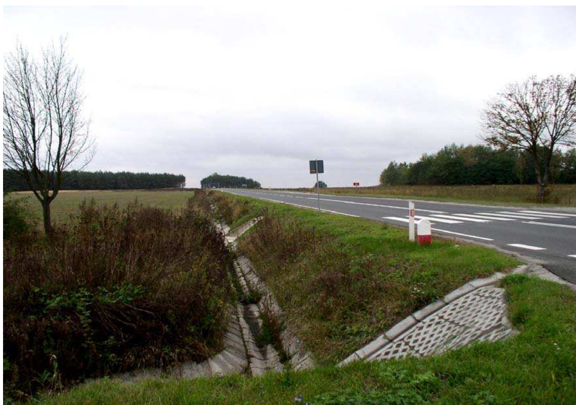
Fot. 12. Kolejny przykład elementu odwodnienia w stanie zadowalającym (pomimo roślinności pomiędzy prefabrykatami betonowymi).
