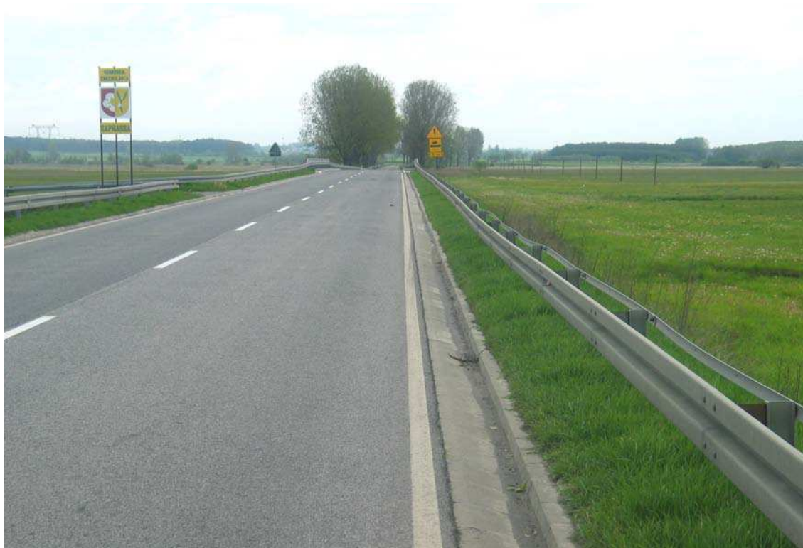
Fot. 60. W przypadku widocznym na fotografii, usytuowania elementu odwodnienia – rynny ściekowej bezpośrednio przy jezdni, pobocze nieutwardzone nie podlega ocenie.
