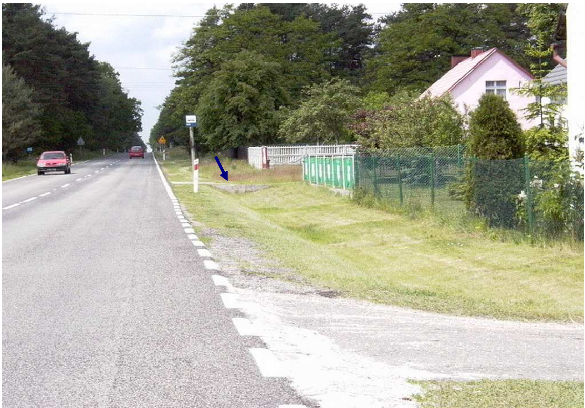
Fot. 28. Niedrożny rów odwadniający – zjazd bez przepustu na prywatną posesję.
