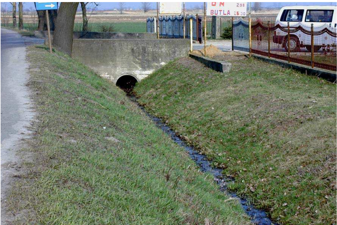
Fot. 74. Mimo niewielkiego zamulenia przepustu (rozpatrując wyłącznie wysokość zamulenia przekroju) światło przepustu jest ograniczone do 30 % jego przekroju. W takim przypadku należy ocenić stan elementu jako niezadowalający.
