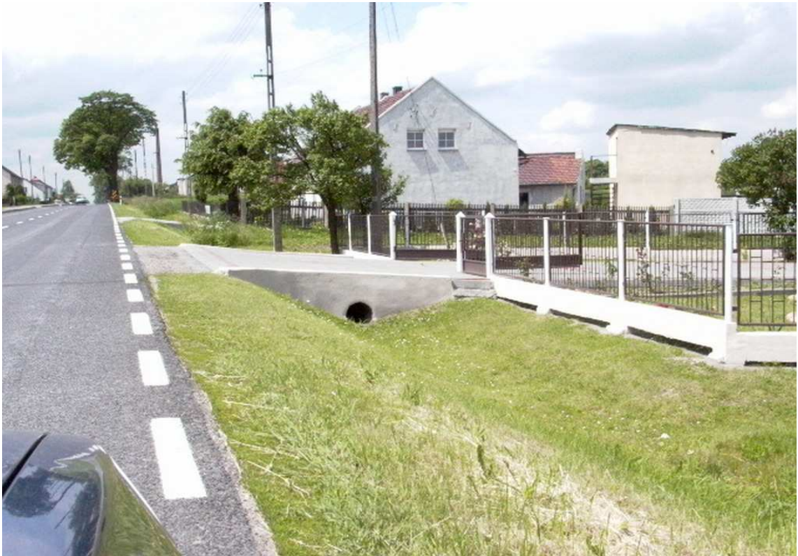
Fot. 13. Odwodnienie z wyraźną linią rowu oraz drożnym przepustem, zamulony poniżej 15% wysokości przekroju.
