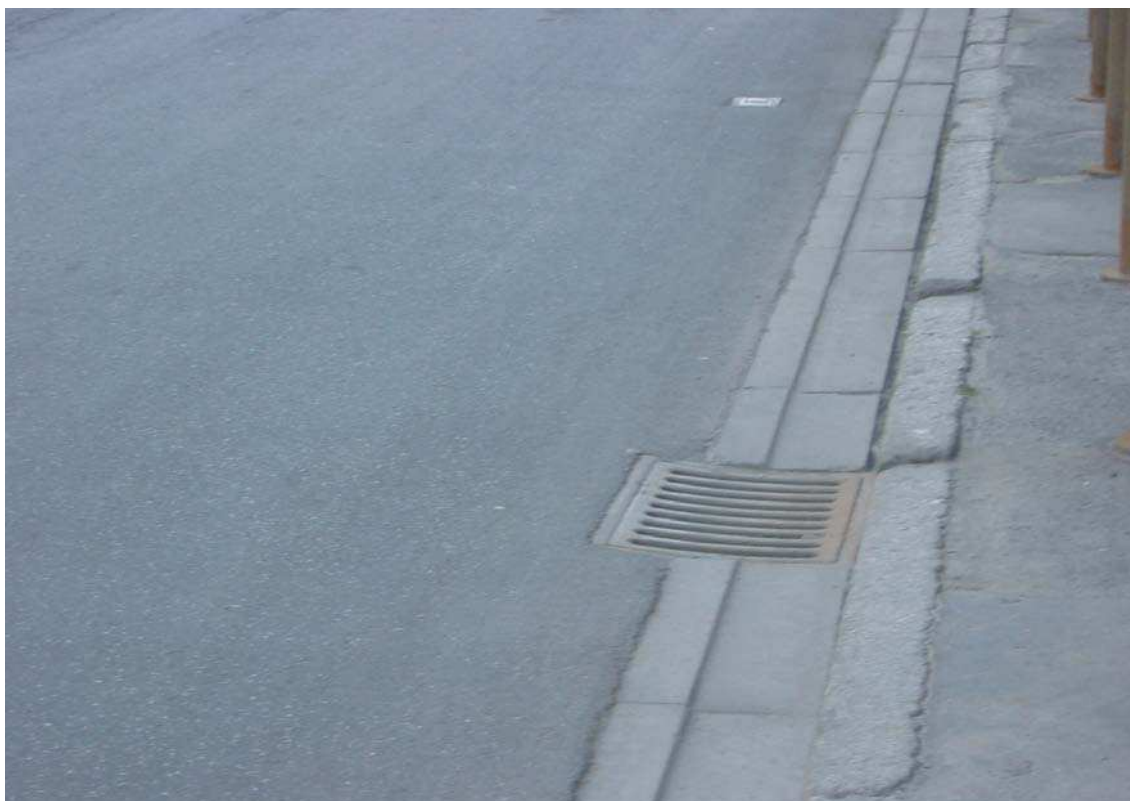
Fot. 32. Rynna przykrawężnikowa wraz z kratką studzienki w dobrym stanie technicznym.
