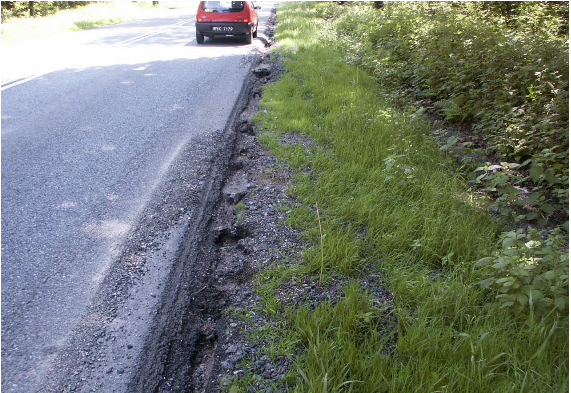
Fot. 58. Pobocze punktowo skoleinowane – stan zły.
