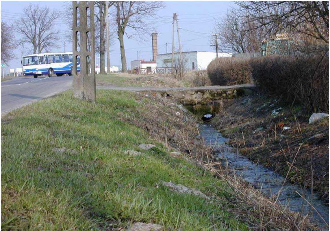
Fot. 21. Elementy odwodnienia częściowo zamulone oraz ograniczone światło przepustu do 30% – stan niezadawalający.
