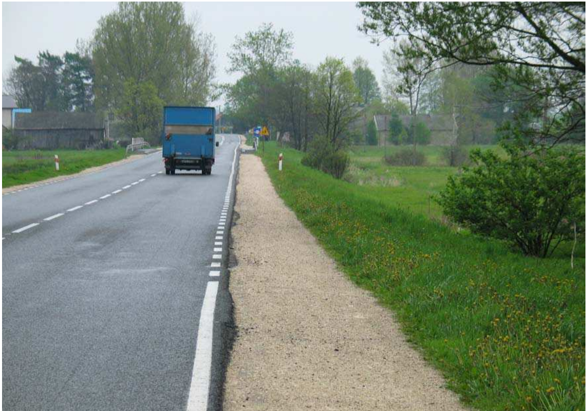
Fot. 46. Kolejny przypadek pobocza w stanie niezadowalającym pomimo wcześniejszego wykonania zabiegu uzupełnienia.
