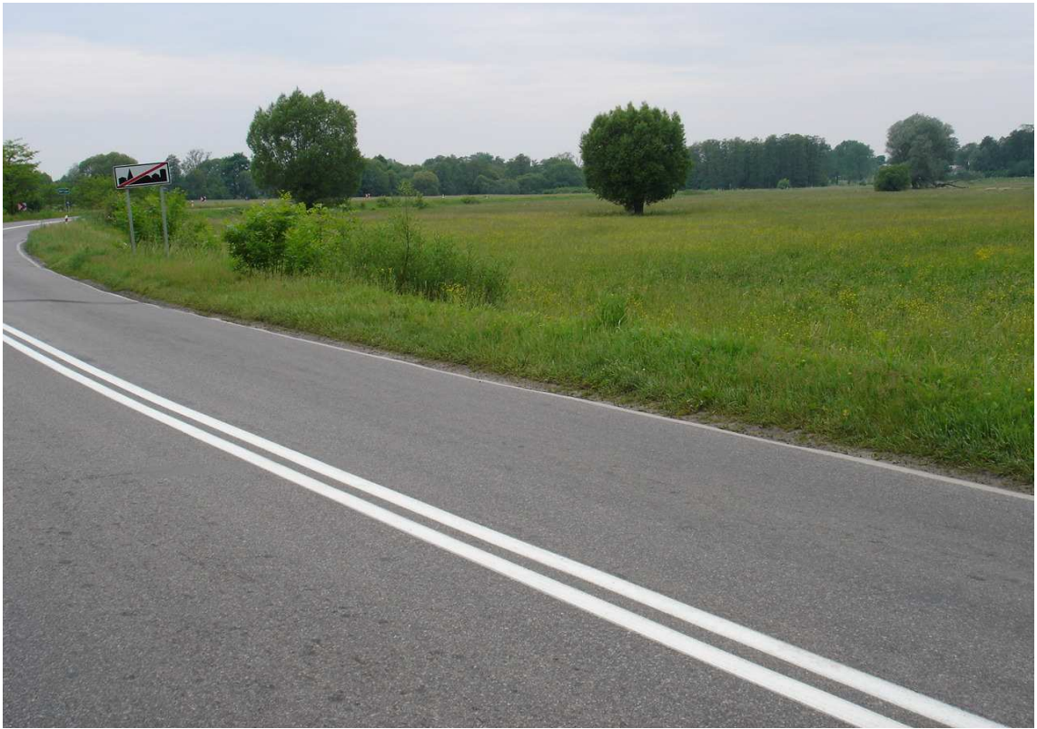
Fot. 52. Kolejny przykład pobocza zawyżonego na całej długości hektometra.
