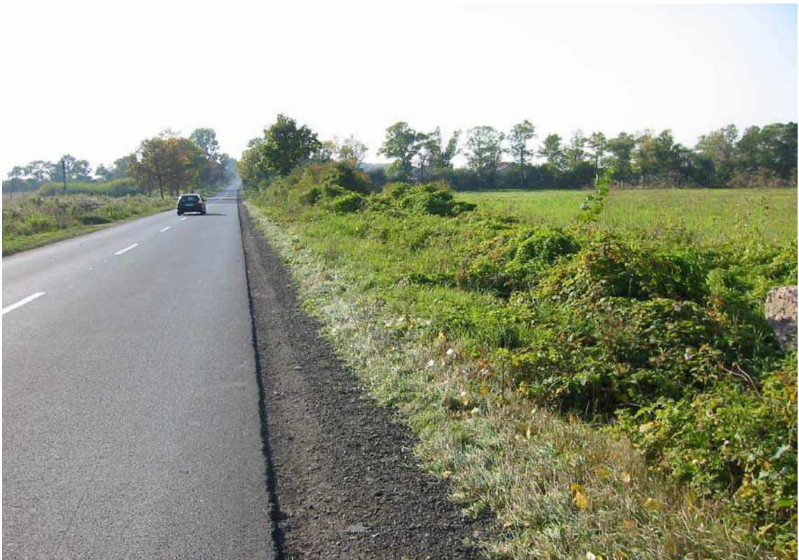
Fot. 55. Przykład pobocza skoleinowanego w stanie niezadowalającym – dodatkowo widoczne odwodnienie w złym stanie technicznym.
