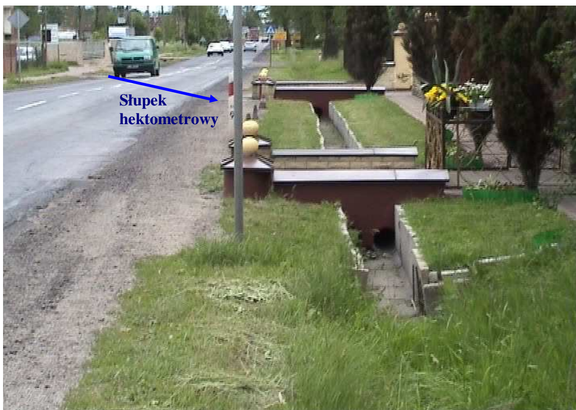
Fot. 76. Dwa kolejne hektometry w stanie złym, pomimo istniejących częściowo elementów odwodnienia – na początku i końcu brak ciągłości, rowy wymagają odbudowy.
