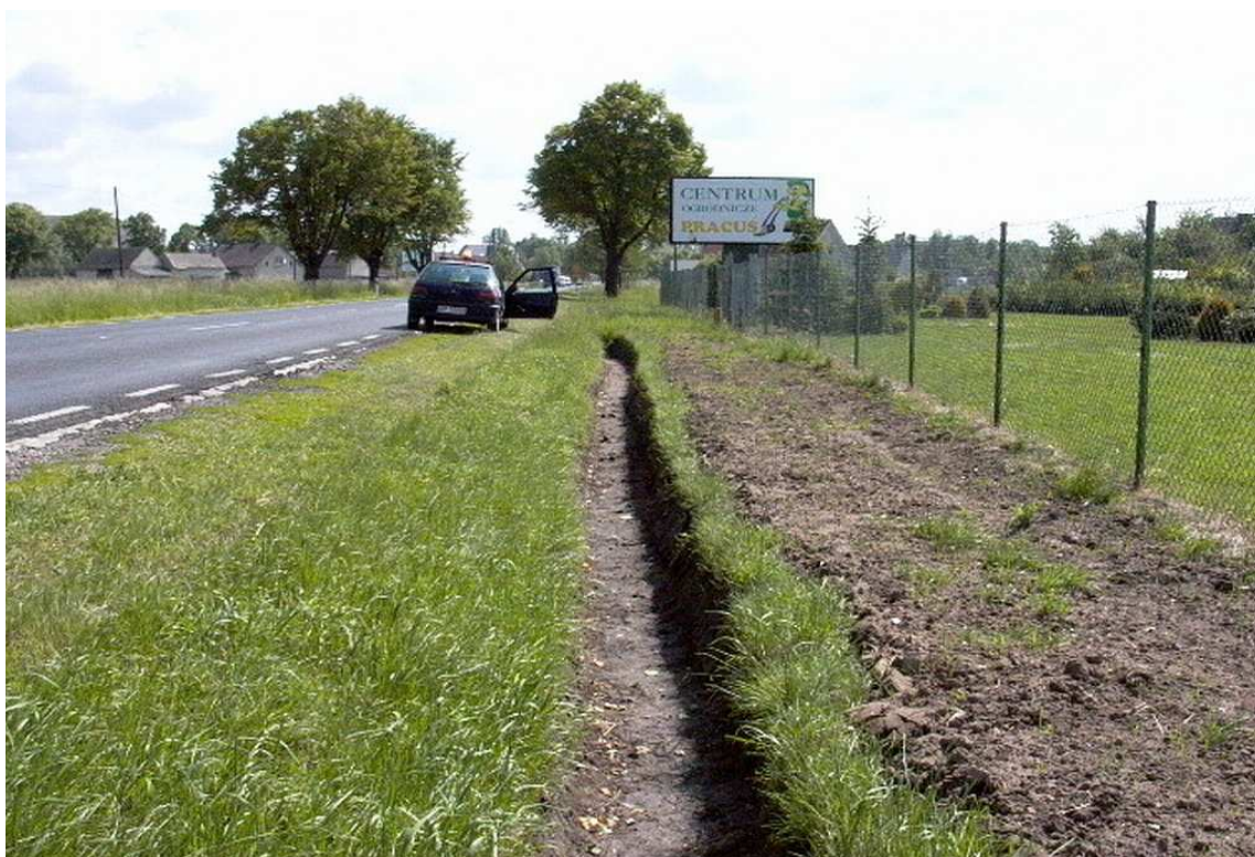
Fot. 75. Przykład odwodnienia w stanie złym. Rów wykonany prawdopodobnie przez właściciela przylegającej posesji.
