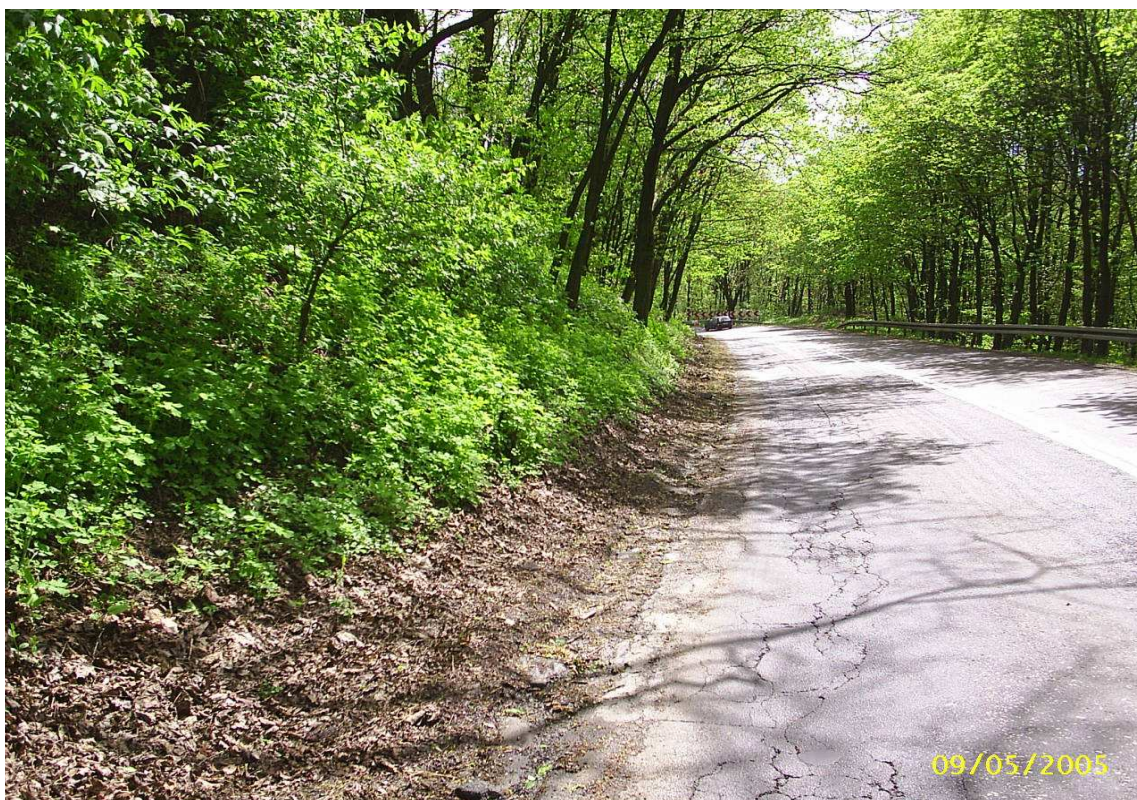
Fot. 29. Brak elementu odwodnienia – stan zły, niezbędne indywidualne rozwiązanie.
