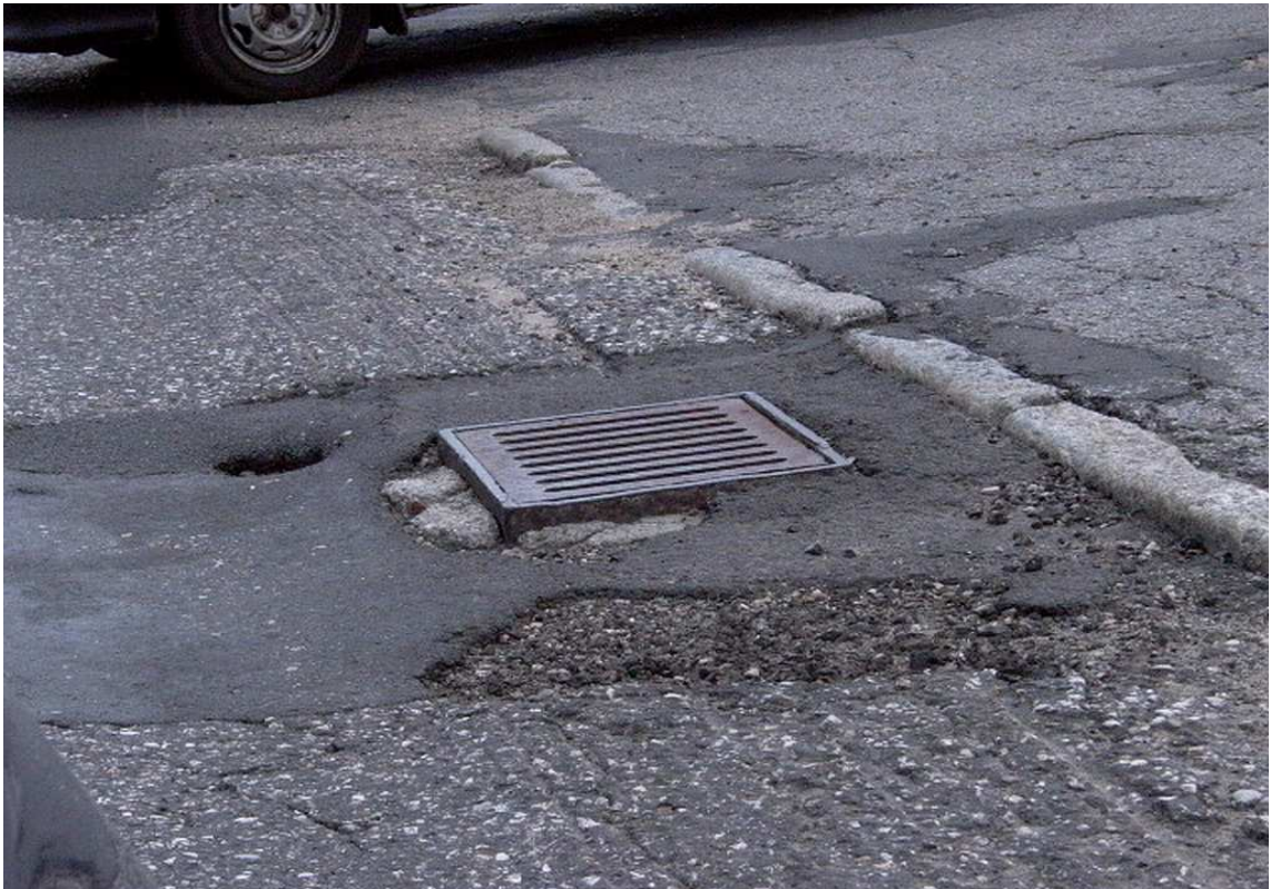
Fot. 38. Kratka studzienki zawyżona względem nawierzchni jezdni.
