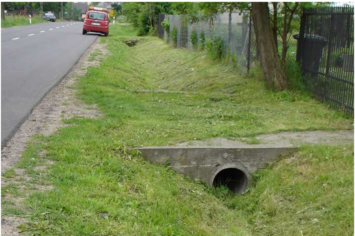
Fot. 14. Odwodnienie w stanie zadowalającym, przepust nieznacznie zamulony.
