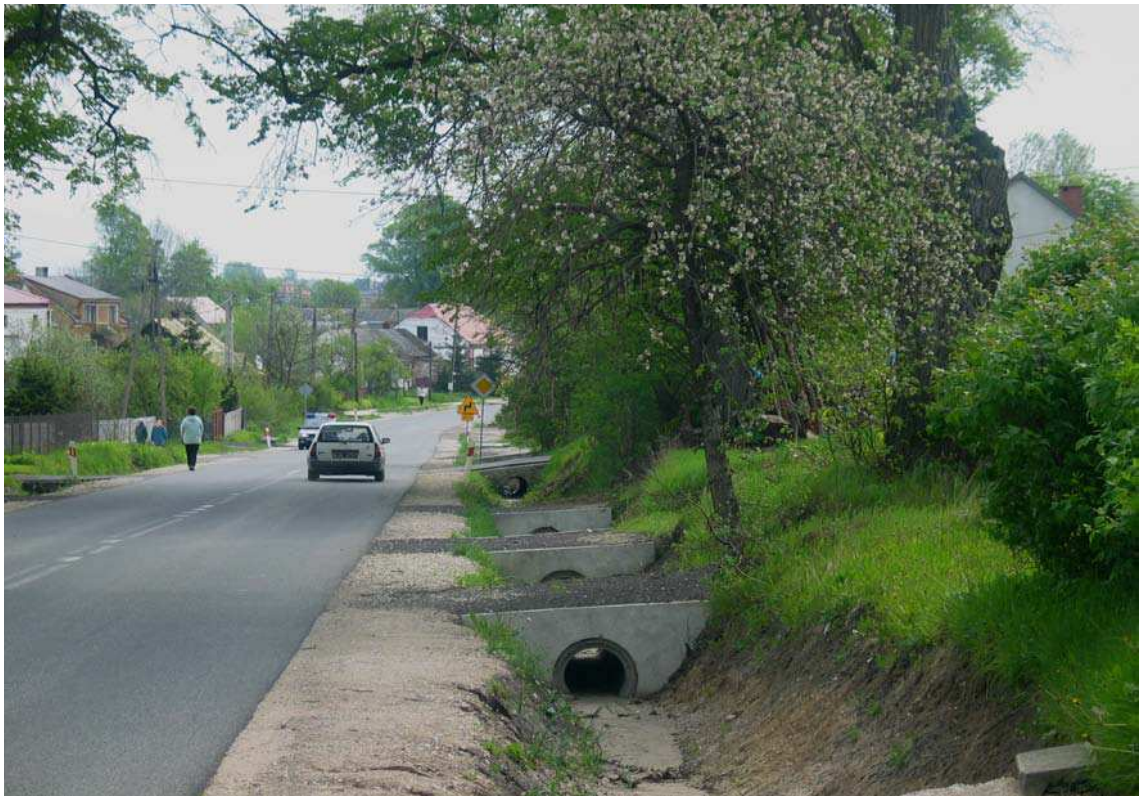
Fot. 10. Wyraźna linia rowu, przepust z widocznym prześwitem, zamulony do 15% wysokości przekroju. Miejscowe nieznaczne zamulenie dna rowu.
