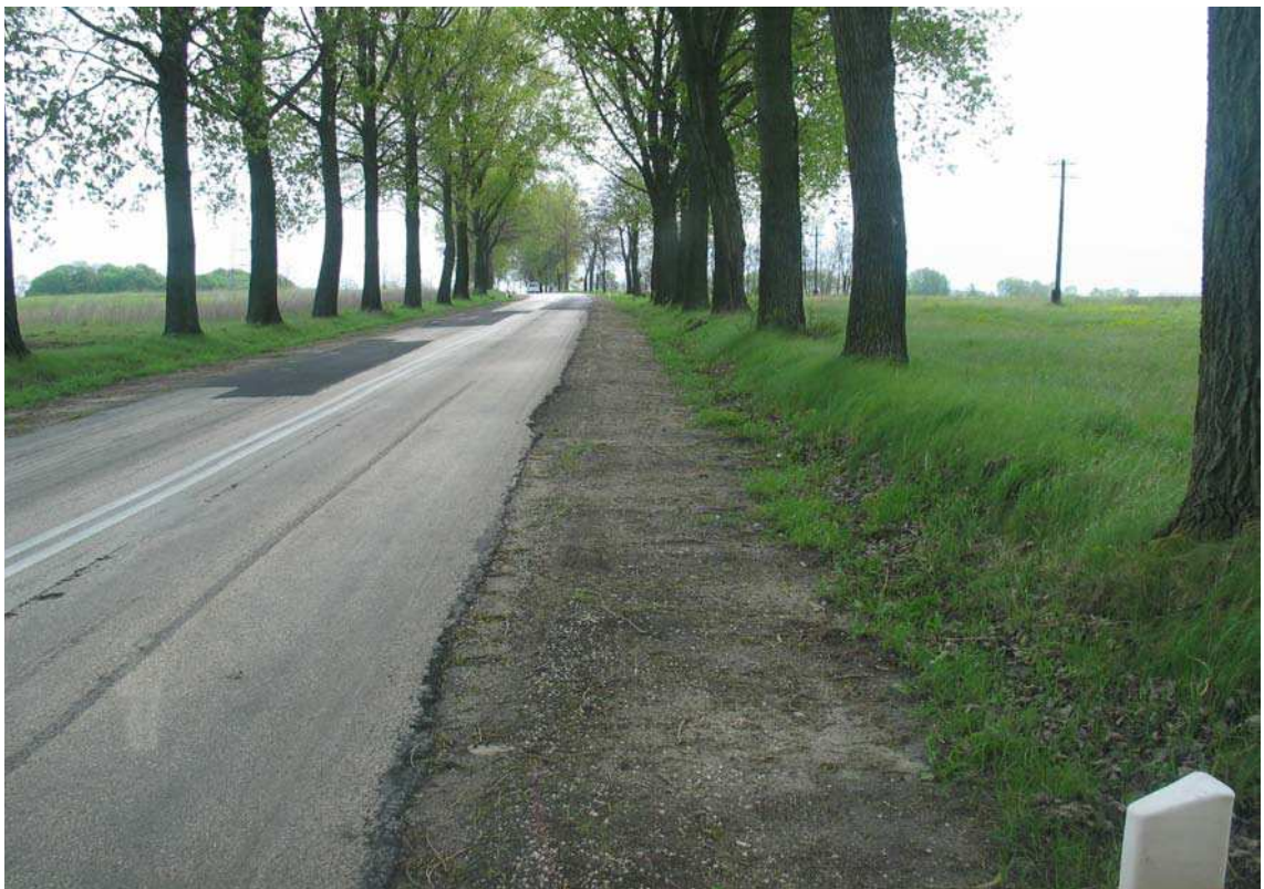
Fot. 47. Pobocze z wyraźnym uskokiem i licznymi uszkodzeniami krawędzi.
