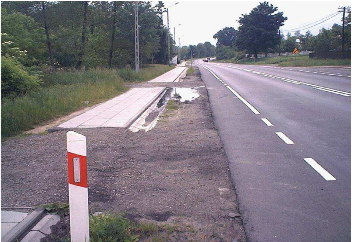
Fot. 36. Rynienka częściowo zasypana, niedrożna na kilku odcinkach.
