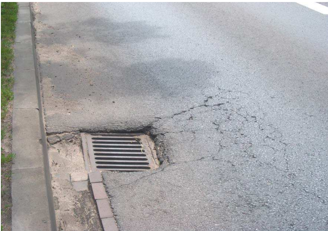
Fot. 34. Spękana nawierzchnia wokół wpustu studzienki kanalizacyjnej – stan zadowolający.
