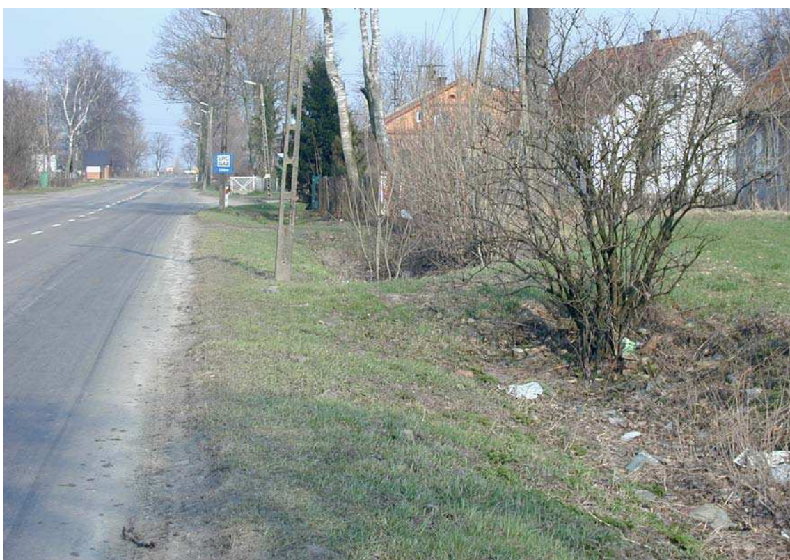
Fot. 30. Odwodnienie zasypane i zarośnięte drzewami.
