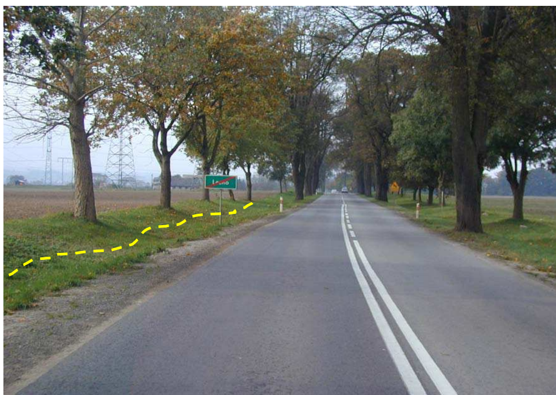
Fot. 20. Odwodnienie w stanie niezadawalającym – nieregularna linia rowu.
