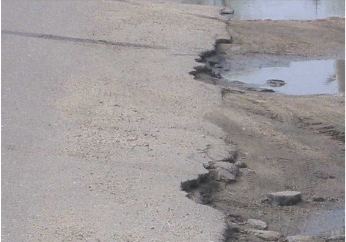
Fot. 50. Przykład uskoku o znacznej wysokości oraz z widocznymi skutkami jego wpływu na nawierzchnię – liczne uszkodzeniami krawędzi jezdni.
