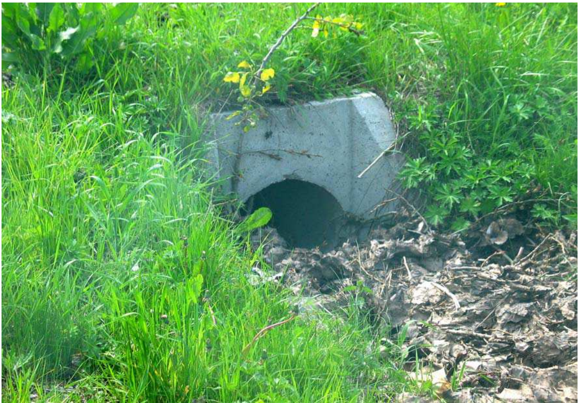
Fot. 24. Przepust zamulony powyżej 30% wysokości przekroju.
