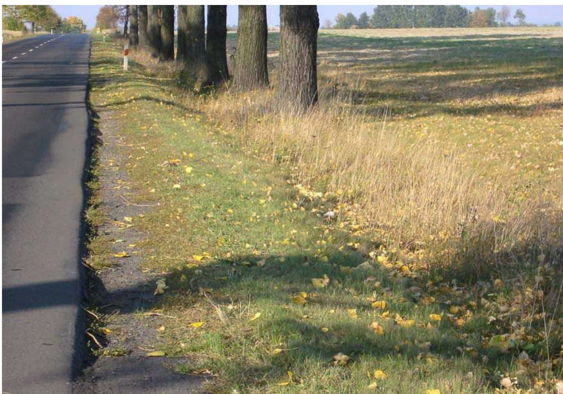
Fot. 48. Przykład zmiany stanu pobocza ze złego w niezadowalający na dwóch kolejnych hektometrach. Pierwszemu hektometrowi (na pierwszym planie) należy przypisać stan zły.
