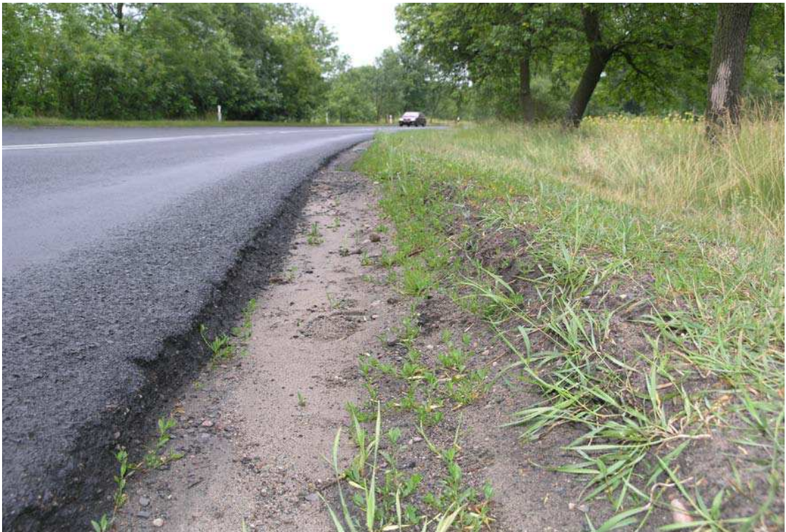
Fot. 59. Pobocze skoleinowane – różnica poziomów ponad 15 cm.
