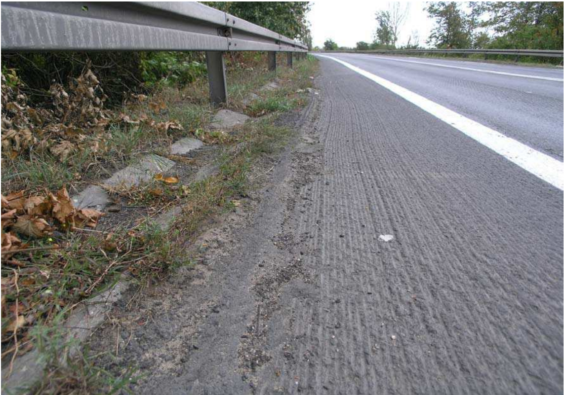
Fot. 23. Rynna odprowadzająca zasypiana i uszkodzona.
