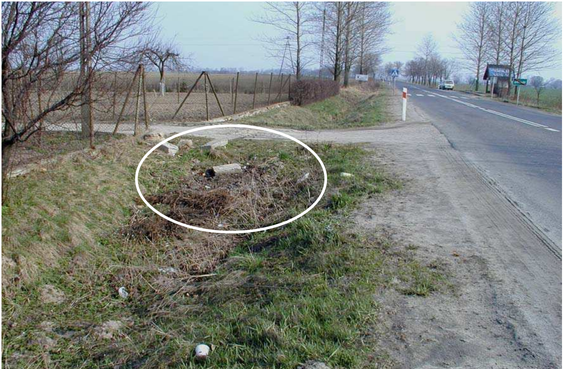
Fot. 69. W przypadku wystąpienia, jednego niedrożnego przepustu na ocenianym hektometrze, cały hektometrowi pod względem odwodnienia należy przypisać stan zły.
