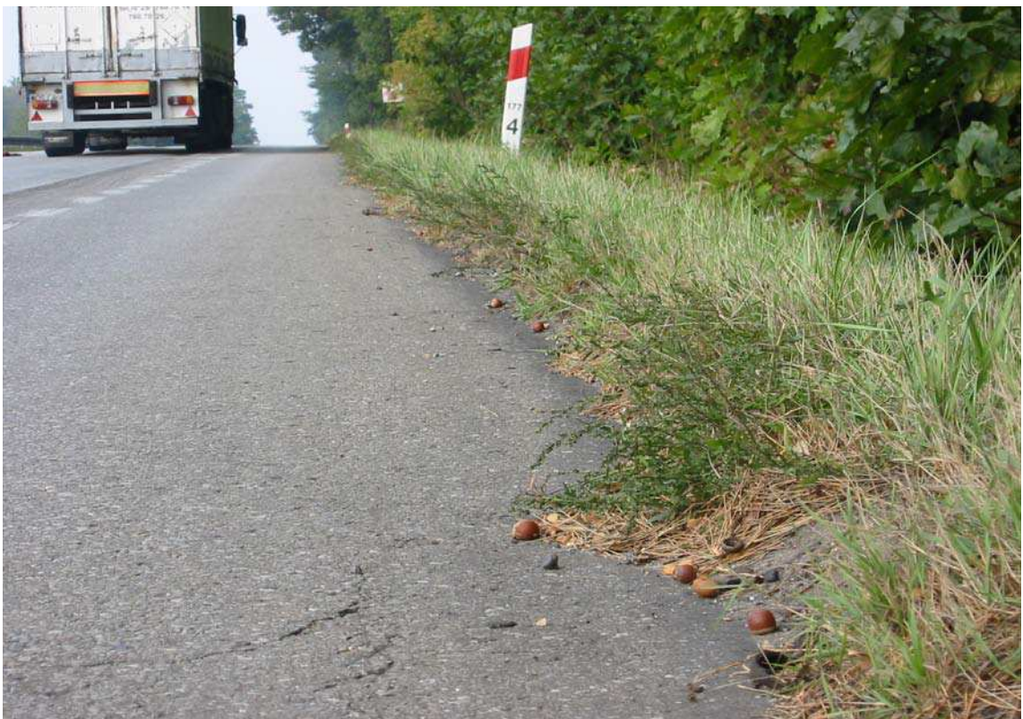
Fot. 51. Przykład pobocza zawyżonego, widoczne fragmenty gruntu znajdujące się na jezdni.
