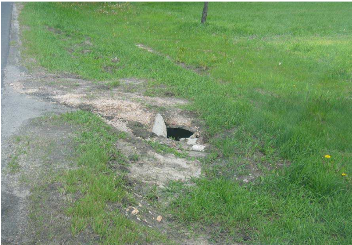
Fot. 26. Zarwany przepust pod zjazdem z drogi.
