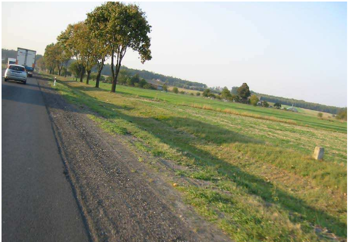
Fot. 43. Pobocze z niewielkim uskokiem uzupełnione tłucznem, można zaobserwować początki tworzenia się pobocza skoleinowanego (na pierwszym planie).
