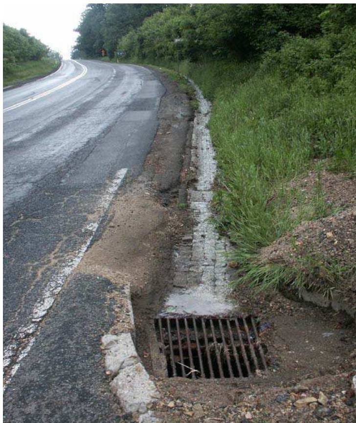
Fot. 15. Rynna odprowadzająca nieznacznie zasypana piachem, zakończona wpustem z kratką ściekową – spełniająca swoją funkcję.
