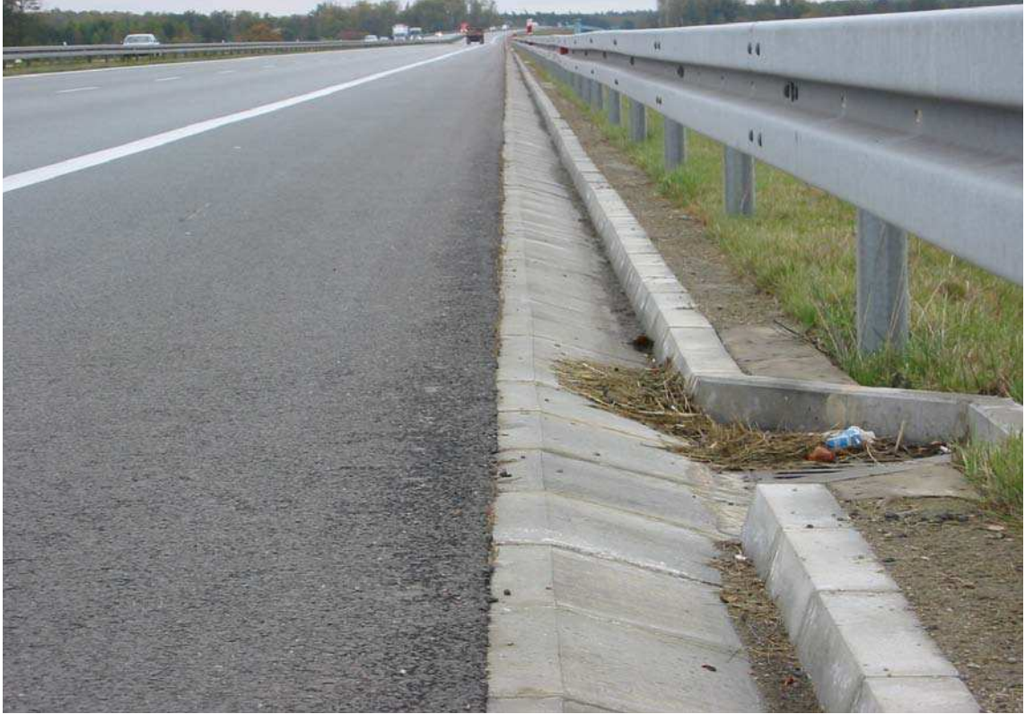
Fot. 5. Pomimo zalegania naniesionych zanieczyszczeń na części rynny odprowadzającej elementom odwodnienia należy przypisać stan dobry.
