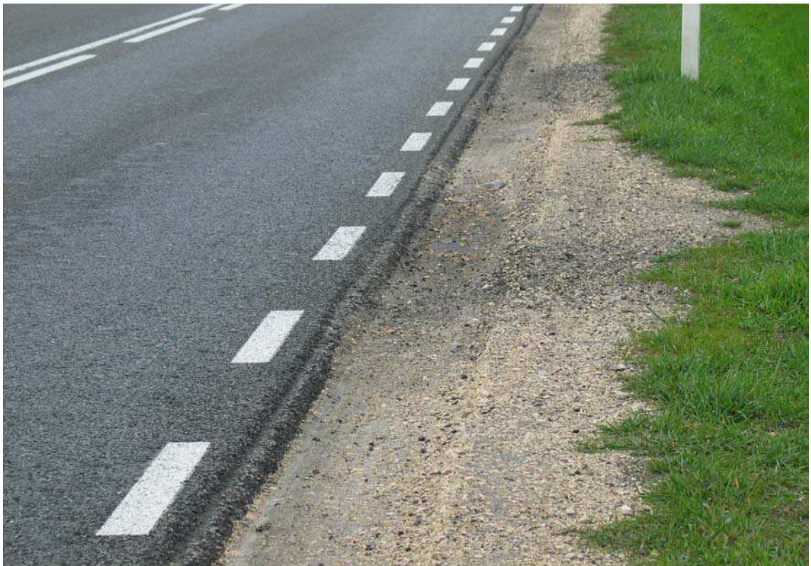
Fot. 45. Pobocze zaniżone w przedziale 5 – 15 cm.
