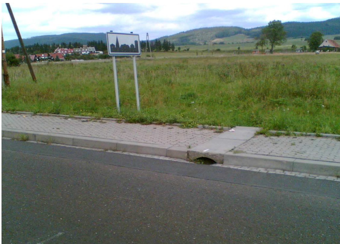
Fot. 66. Równoległe elementy odwodnienia – rynna w stanie zadowalającym, rów w złym stanie technicznym.
