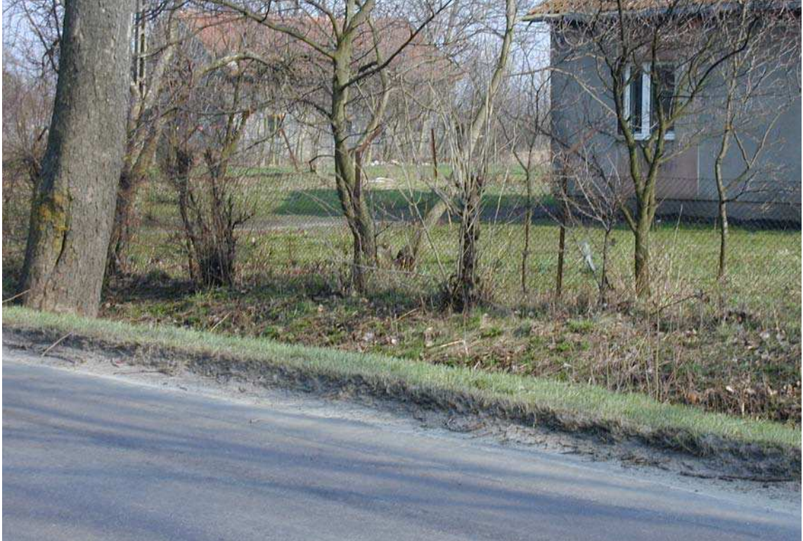
Fot. 54. Pobocze zawyżone sięgające ponad 20 cm nad poziom jezdni.
