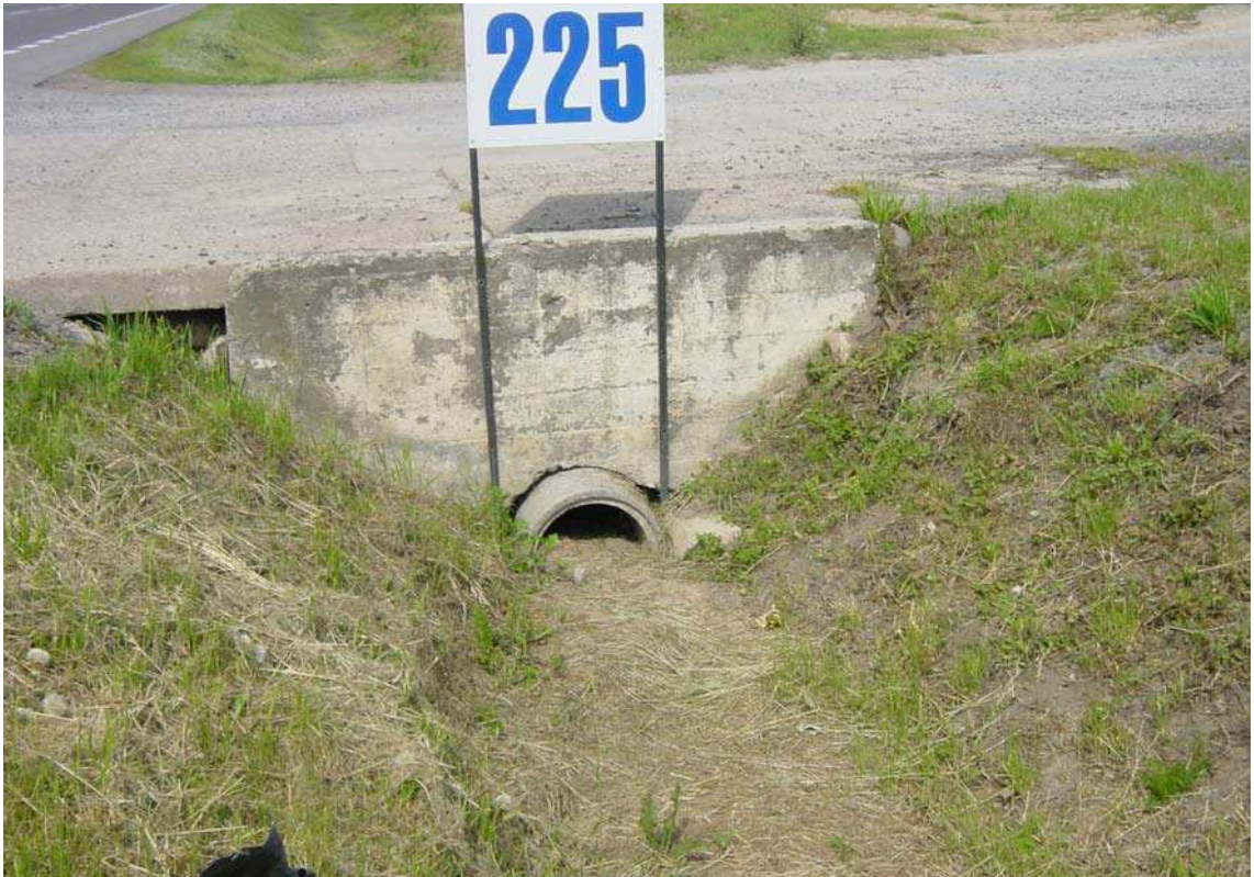
Fot. 27. Przepust zasypyany i zamulony w ponad połowie przekroju.
