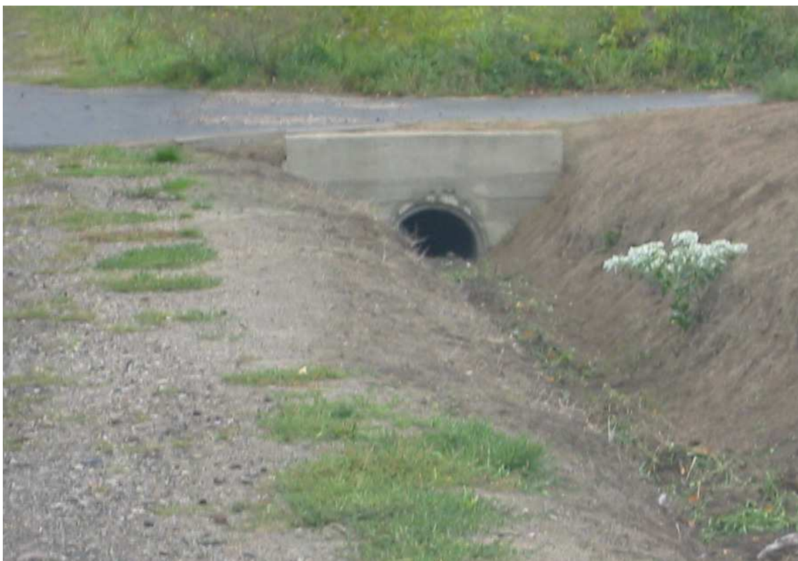
Fot. 19. Przepust zamulony powyżej 15% przekroju.
