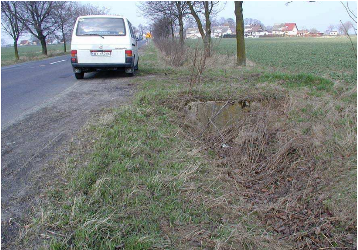
Fot. 25. Rów odwadniający z całkowicie zasypanym przepustem.
