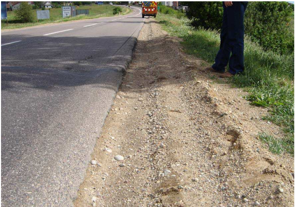
Fot. 57. Pobocze szeroko skoleinowane – stan zły.
