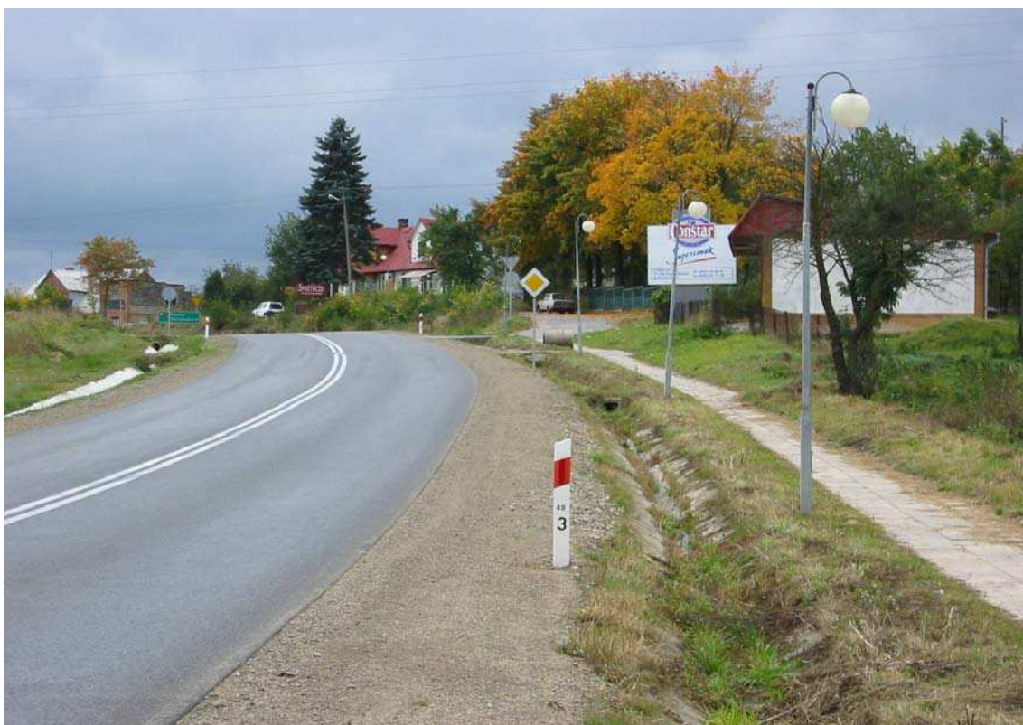
Fot. 17. Przykład rowu zamulonego i zarośniętego kępami roślinności pomiędzy elementami betonowymi.
